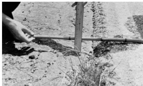
Figura 3.24– Desnível pista- acostamento com média severidade
