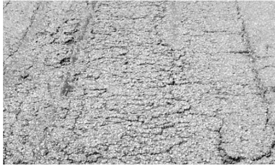
Figura 3.21 - Intemperismo e desgaste com média severidade
