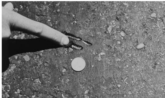
Figura 3.22 - Exsudação com média severidade
