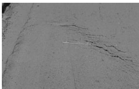
Figura 3. 12 – Trincas de derrapagem com severidade média
