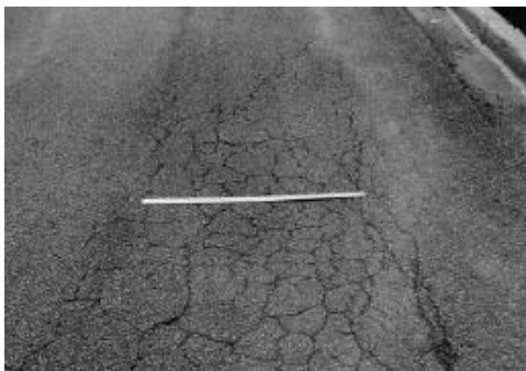
Figura 3.9 – Trinca por fadiga com severidade média.
