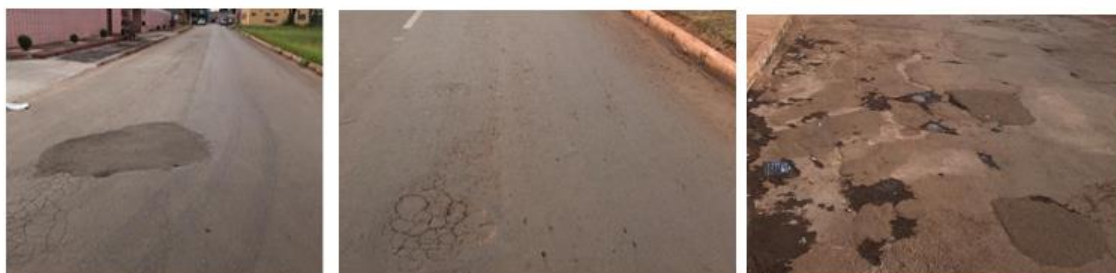
Quadro 5.1 – Remendos, Trincas por fadiga e Desgaste encontrados nos segmentos avaliados
