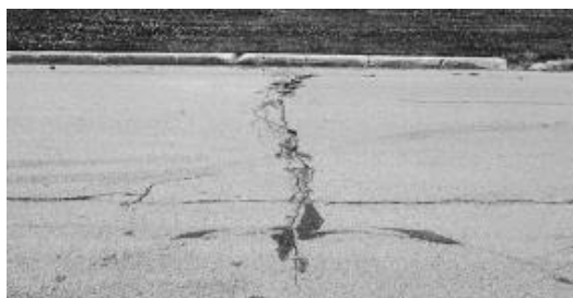
Figura 3. 11– Trincas longitudinais e transversais com severidade alta
