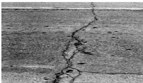
Figura 3.10– Trinca por reflexão das juntas com severidade média.
