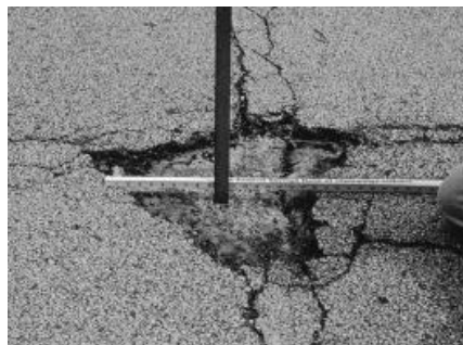
Figura 3.14– Buraco com severidade média.
