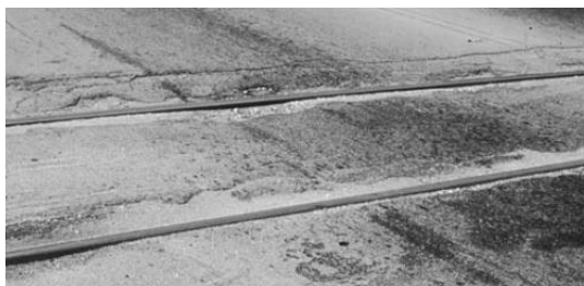
Figura 3.25 - Cruzamento de linha férrea com média severidade
