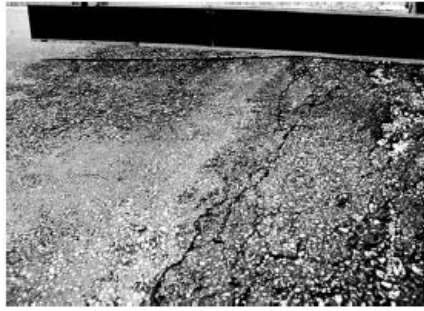
Figura 3.15 – Inchaço e afundamentos com severidade alta .
