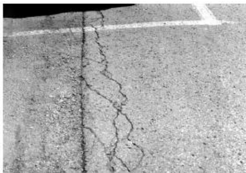
Figura 3.8 – Trinca nos bordos laterais com média severidade.
