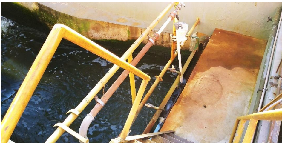
Figura 5.13: Tubulação de dosagem de sulfato de alumínio.
