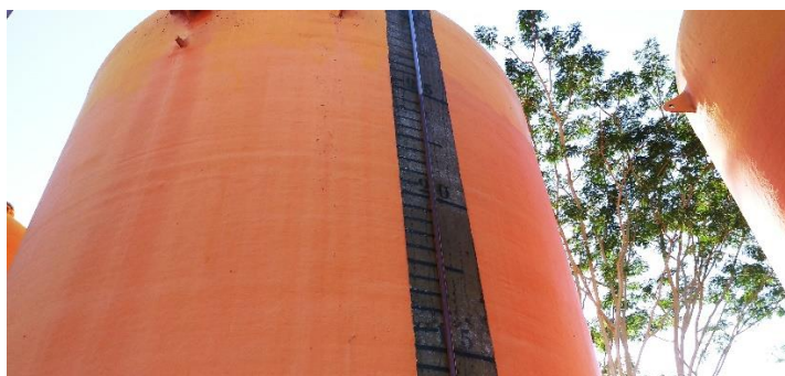
Figura 5.14: Reservatório de sulfato de alumínio.
