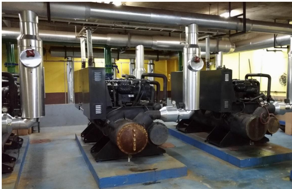
Figura 6.14 - Chiller de condensação a água (O AUTOR, 2018).
