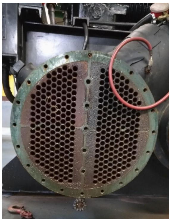
Figura 6.15 - Vista em detalhe do sistema casco e tubo do chiller (O AUTOR, 2018).
