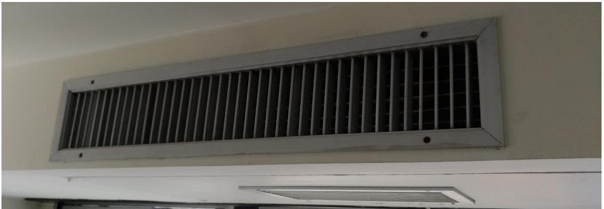
Figura 6.18 - Fancoil original utilizado no edifício (O AUTOR, 2018).
