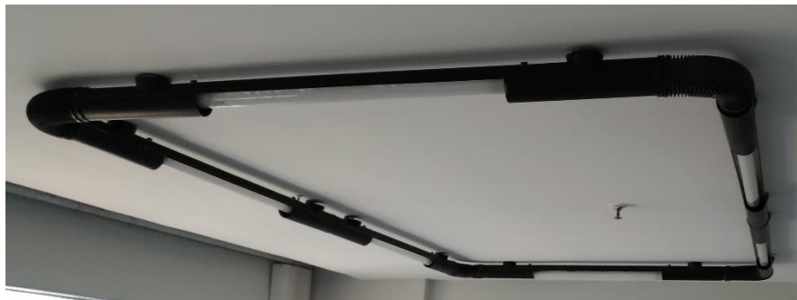
Figura 6.13 - Luminária utilizada em corredores, escadas e subsolo no BTC (O AUTOR, 2018).
