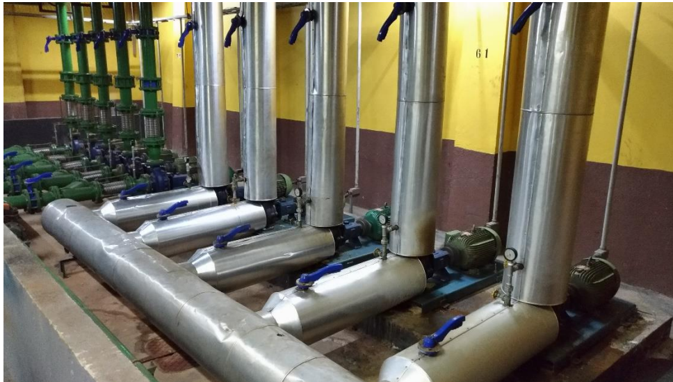
Figura 6.16 - Bombas de água gelada e água de condensação (O AUTOR, 2018).
