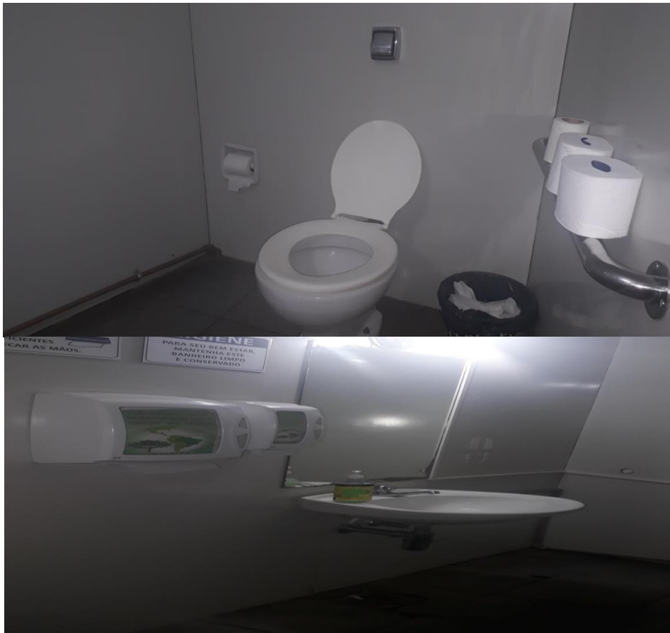
Figura 19: Sanitário adaptado do Teatro Plínio Marcos
