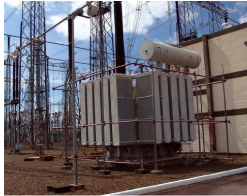
Figura 3 – Reator shunt de 765 kV na subestação de Foz do Iguaçu.
