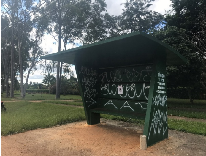
Figura 20: Parada de ônibus antes da implementação do projeto
