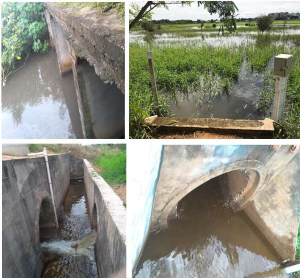
Figura 4.9 – Fotos da bacia de retenção do Guará: galeria de entrada; área alagada após chuva; vertedor; orifício de saída.
