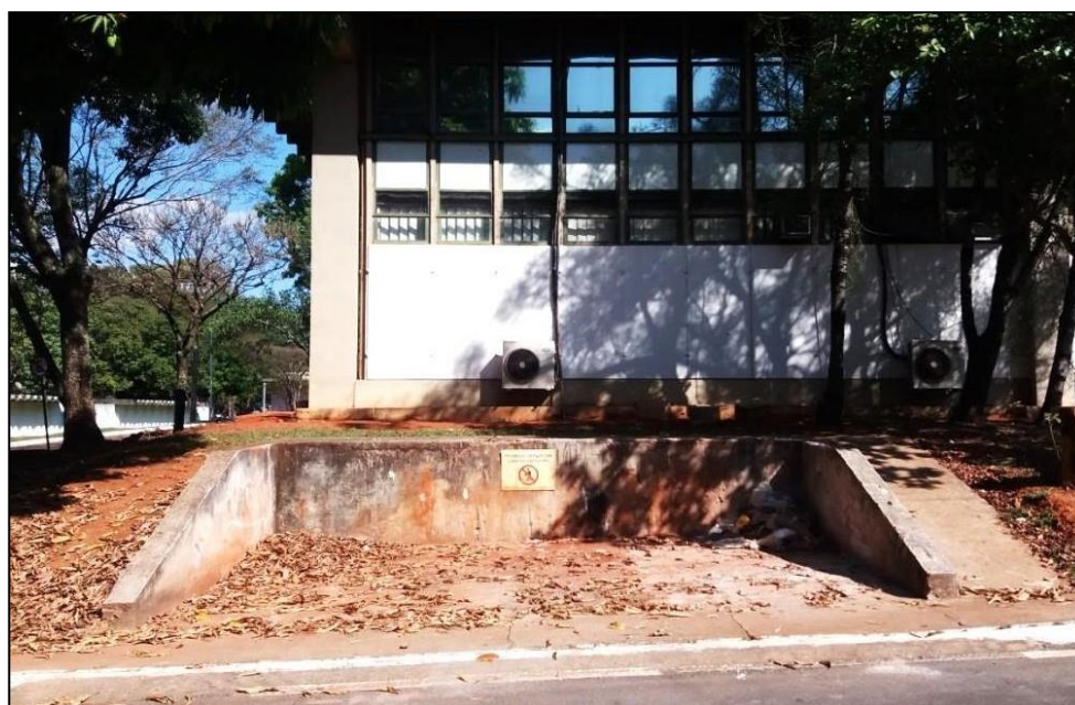
Figura 6.19 – Baia para acondicionamento final de RCC do SG-12
