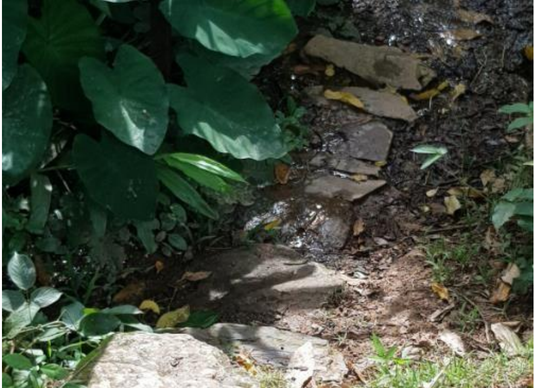
Figura 17 –Degraus de acesso em trilha em desacordo aos padrões de segurança da norma em referência.Fonte: Pesquisa de campo, Nov/2018.
