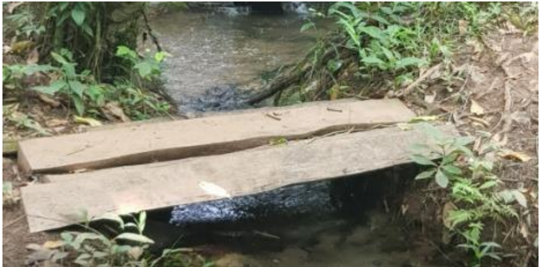
Figura 19 – “Ponte” de acesso em trilhas. Em desacordo aos padrões da norma em referência.
