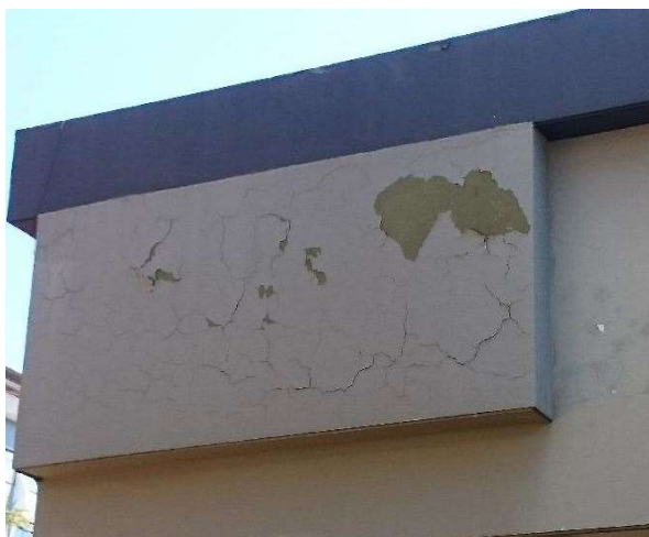
Figura 16 – Fissuração associada com descolamento no sistema de pintura, registro do LEM – UnB
