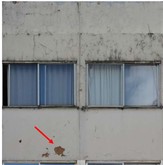
Figura 70 – Amostra DP2 de orientação Oeste e defeito escolhido para observação (seta vermelha).
