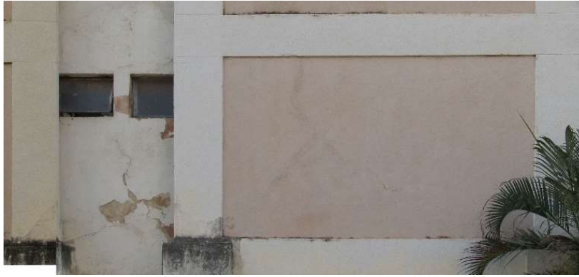
Figura 24 – Registro fotográfico da região de fissuração na amostra F1 (LEM – UnB).
