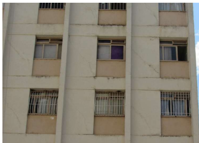
Figura 10 – Fissurações diagonais no revestimento devido a alterações nas condições de apoio, registro do LEM – UnB.
