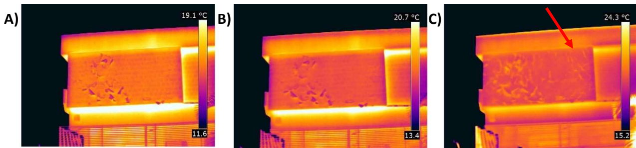
Figura 64 – Termograma às 7h30 (“A”), 8h30 (“B”) e 10h00 (“C”) da amostra FP1.
