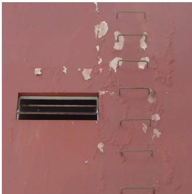
Figura 17 – Bolhas na pintura e descolamento.
