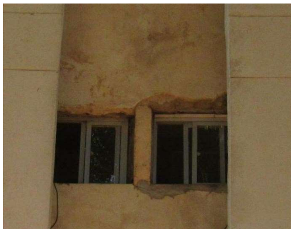
Figura 15 – Desagregação em fachada com acabamento em reboco e pintura de edifício em Brasília, registro LEM – UnB.
