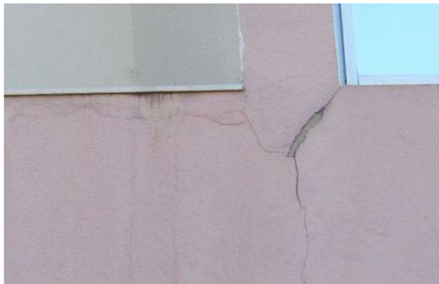
Figura 11 – Fissuração devido à ausência ou subdimensionamento de vergas na região de aberturas, registro do LEM – UnB
