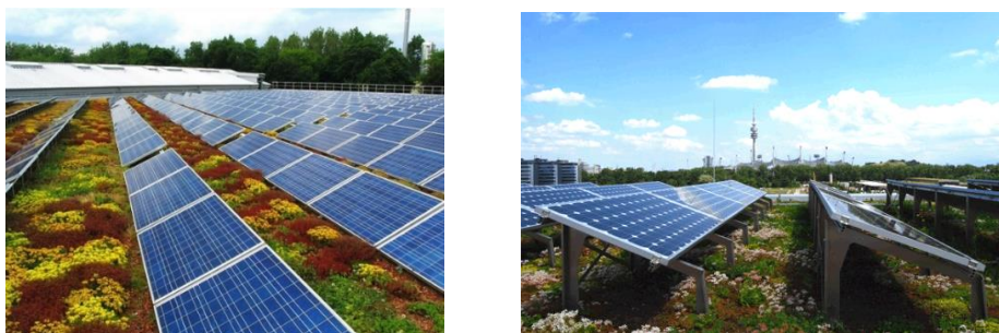
Figura 3.12: Sistema de telhado verde combinado ao sistema de geração de energia solar fotovoltaica (INSTITUTO CIDADE JARDIM, 2017).
