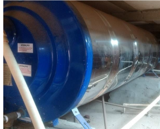
Figura 20. Reservatório térmico – Boiler
