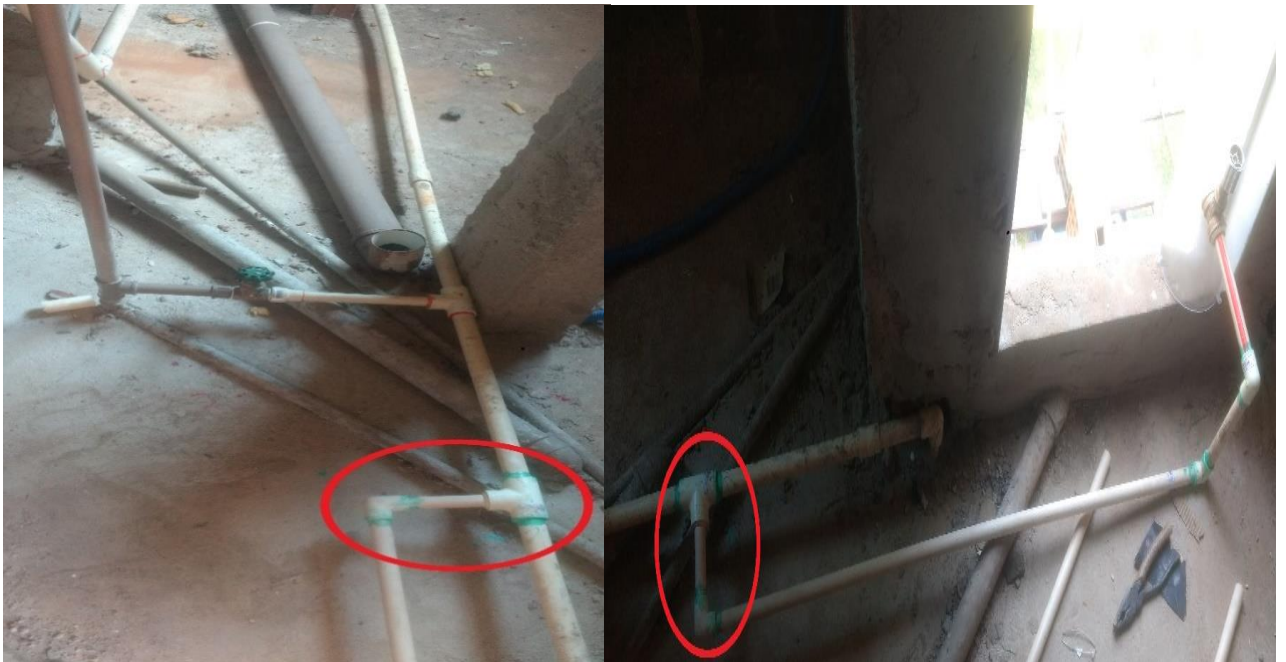
Figura 21. Desvio na tubulação de fornecimento de água quente da residência
