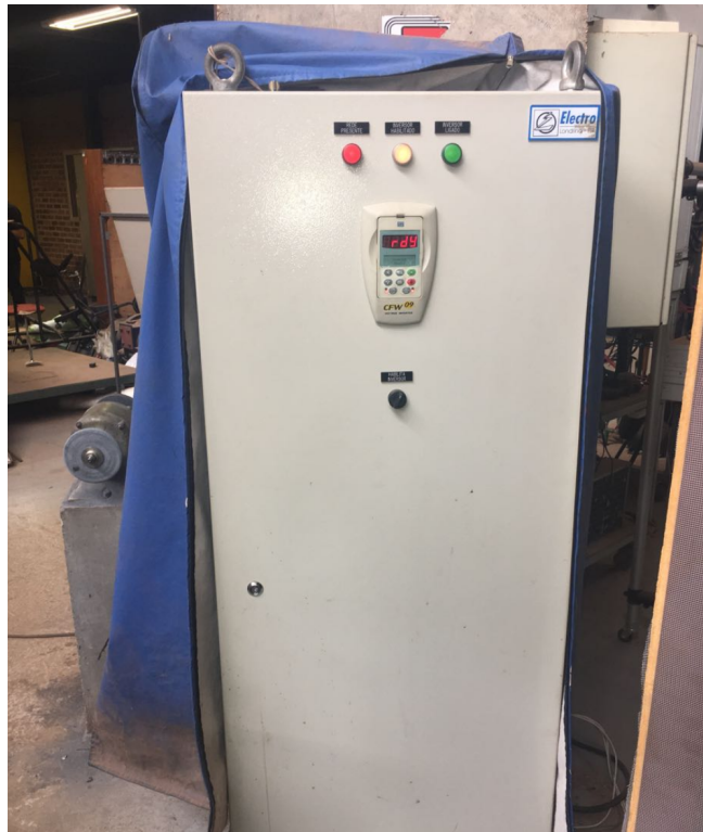
Figura 4.11. Inversor de Frequência
