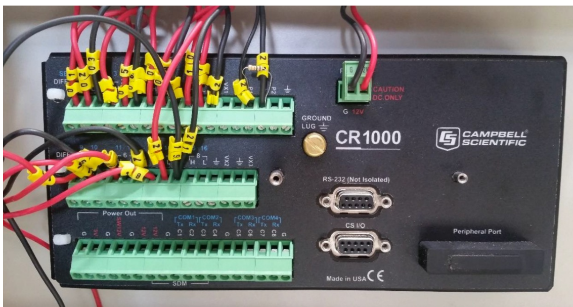
Figura 6.10. Datalogger da bancada de sensores (Cavalcante, 2016)
