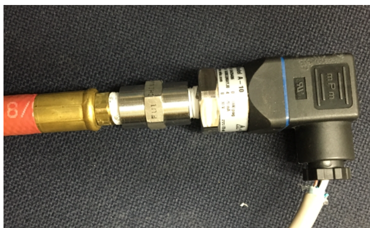
Figura 7.13: Conexão de um sensor de pressão à mangueira de ar comprimido.
