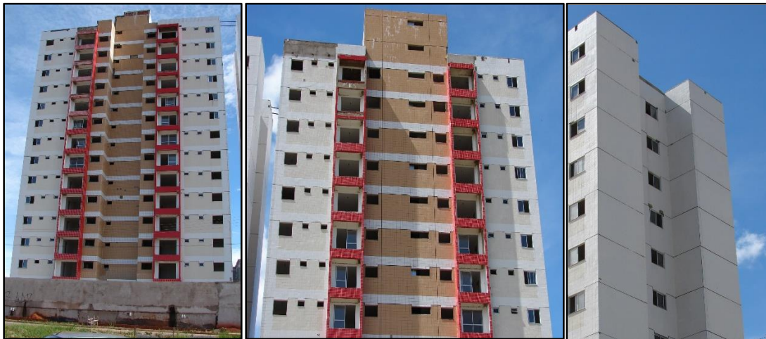
Figura 4.18 - Fotos das fachadas sul (esquerda), norte (centro) e empena oeste (direita) do edifício D.
