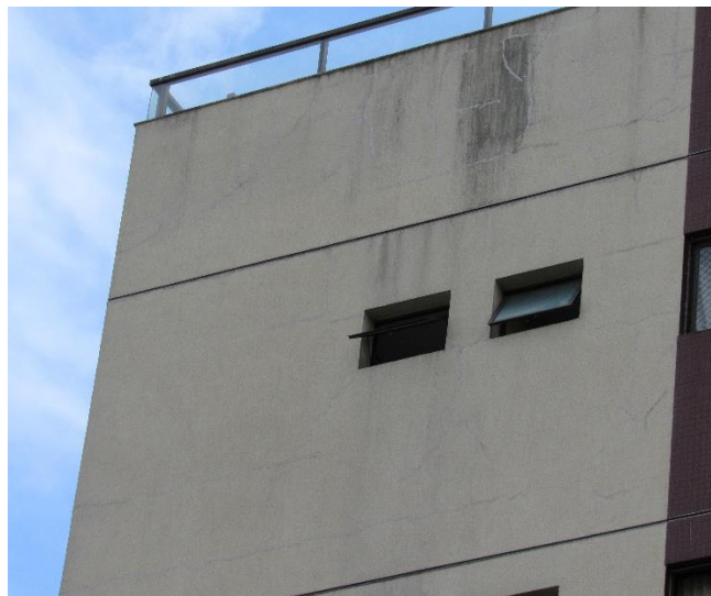
Figura 4.14 - Sinais de fissuras recobertas por selante ao longo de trecho de revestimento em argamassa.
