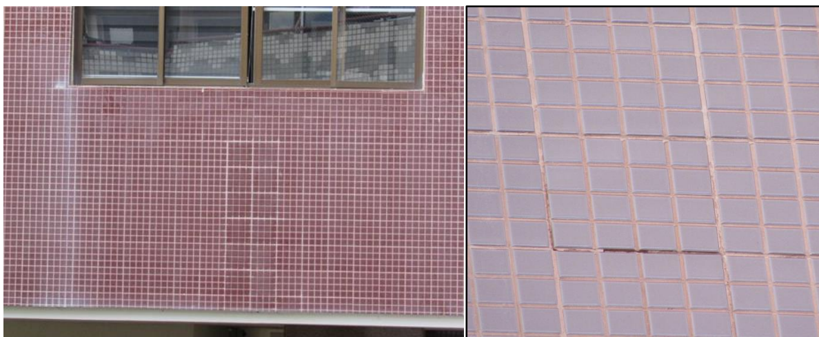
Figura 4.15 - Exemplos de anomalia no edifício. Sinal de substituição de placas (esquerda) e falha de rejunte (direita).
