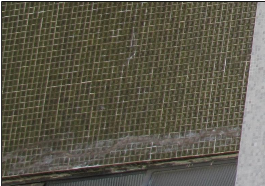
Figura 4.9 - Trecho da fachada Oeste. Sinais de manutenção de fissuras, problemas de umidade no rejunte e possível descolamento de parte das pastilhas.
