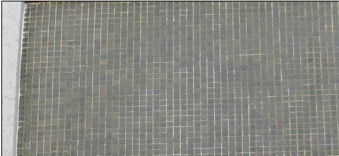
Figura 4.8 - Presença de manchas. Eflorescência possivelmente acompanhada de deslocamento.
