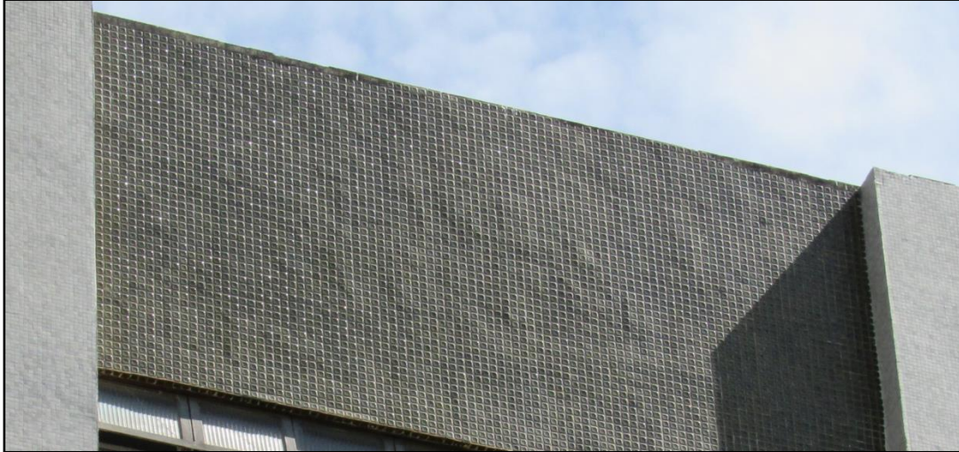
Figura 4.10 – Fotografia indicando sinais de descolamento no topo da empena sul.
