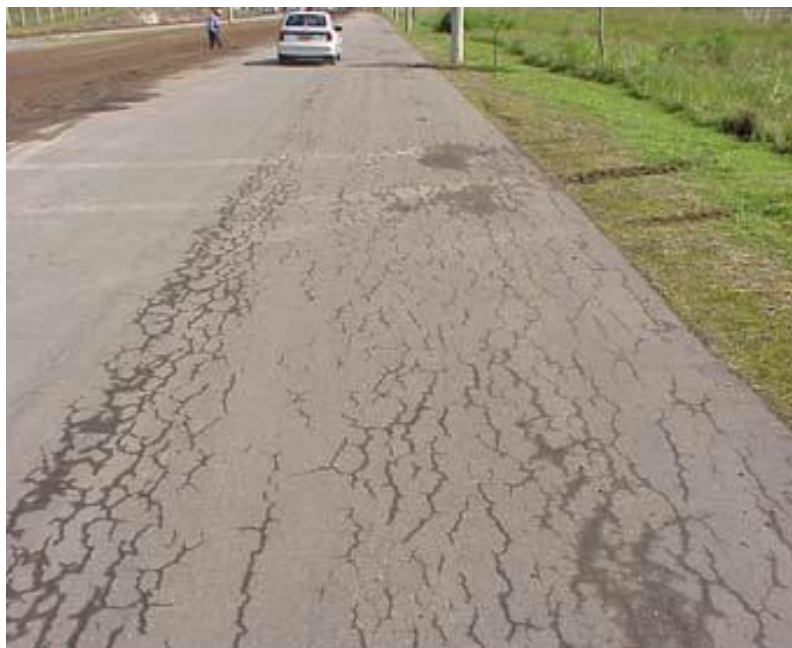
Figura 2.9 - Fissuras no revestimento devido à cura inadequada da escória de aciaria (SILVA, 2002 apud CASTELO BRANCO, 2004)
