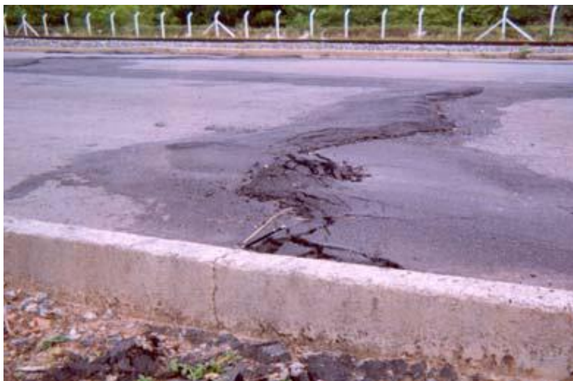
Figura 2.8 - Erupções no revestimento devido à cura inadequada da escória de aciaria (SILVA, 2002 apud CASTELO BRANCO, 2004)
