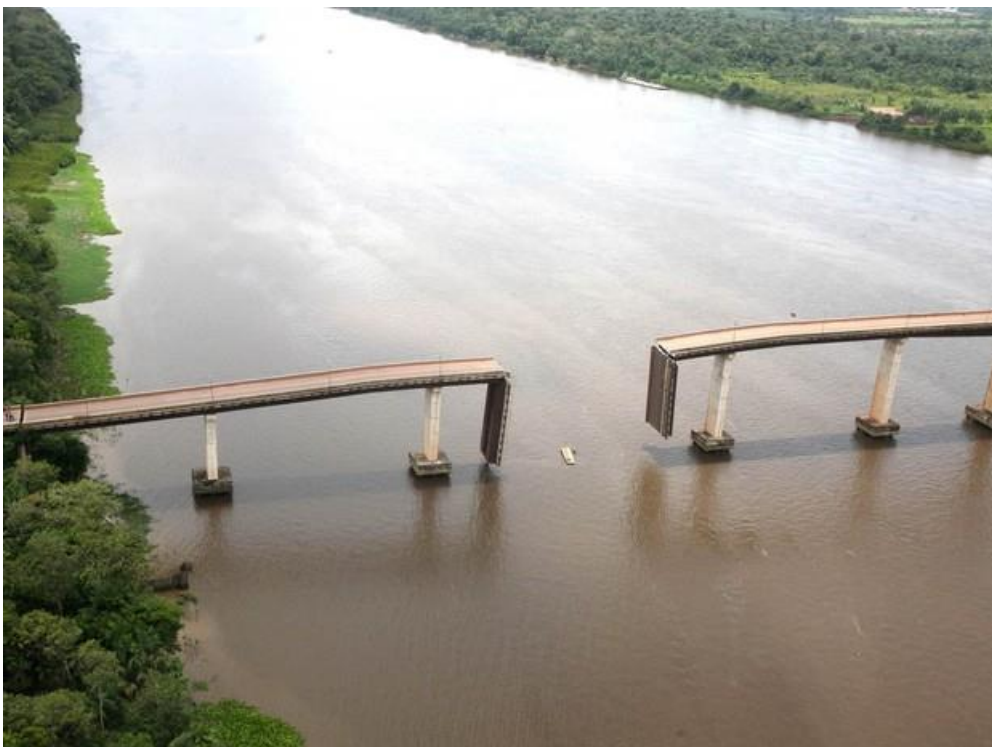
Figura 10– Ponte sobre o Rio Moju após colisão de balsa com um dos pilares da ponte, em março de 2014.
