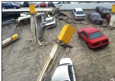
Figura 1.7 – Colapso parcial de um pátio de estacionamento, em Christchurch , Nova Zelândia [https://reidmiddleton.wordpress.com]
