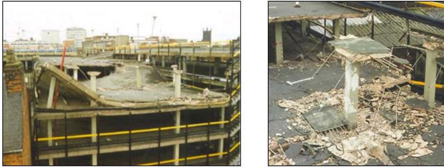
Figura 1.5 – Colapso parcial do edifício Pipers Row Car Park , em Wolverhampton , Inglaterra [WOOD (1997)]
