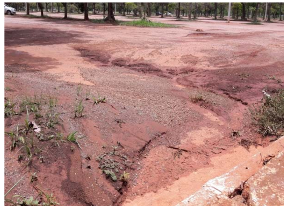
Figura 5-8 – Evidência de sedimentos no estacionamento 2.
