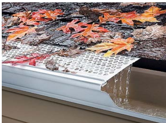
Figura 3-5 – Peneiras ou grades de proteção do sistema de coleta em telhados. Fonte: Gardenista, 2016.
