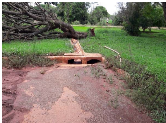
Figura 5-9 – Bocas de lobo do estacionamento 2.
