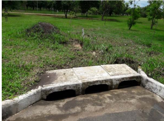
Figura 5-6 – Bocas de lobo responsáveis pela coleta da água do estacionamento 1.
