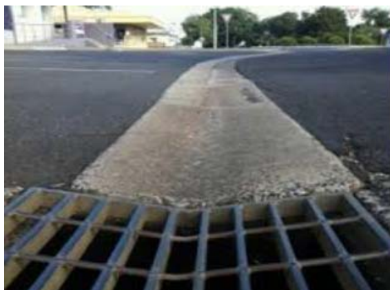
Figura 3-4 – Valeta e dreno. Fonte: Ballina Shire Council, 2016.
