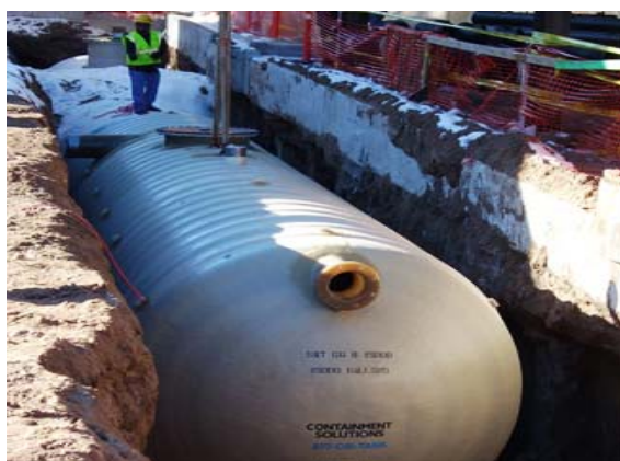
Figura 3-9 – Reservatório subterrâneo para armazenamento de águas pluviais. Fonte: Containment Solutions , 2016.
