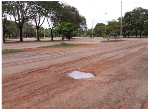
Figura 5-7 – Evidência de buracos no estacionamento 2.
