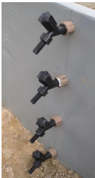
Figura 5. Visualização de quatro torneiras instaladas na lateral do leito.
