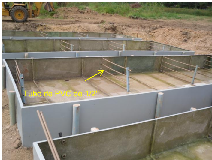
Figura 6. Tubulações no centro do leito que conduz o efluente para cada ponto de coleta (torneiras).
