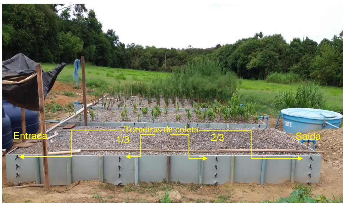
Figura 4. Visualização das torneiras instaladas na lateral dos leitos cultivados.
