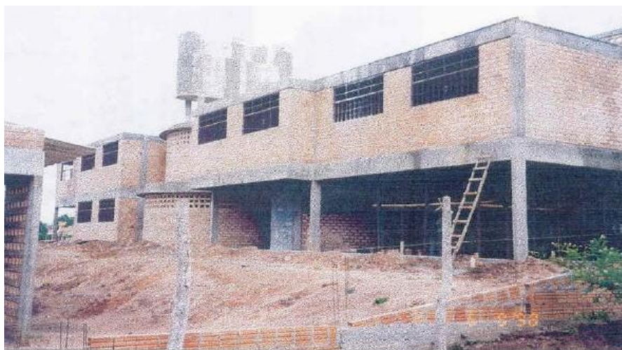
Foto nº 07 – Construção da Escola Estadual Antonio Delfino Pereira – 1998 - Foto de Maria Bernadete Siqueira Loureiro
