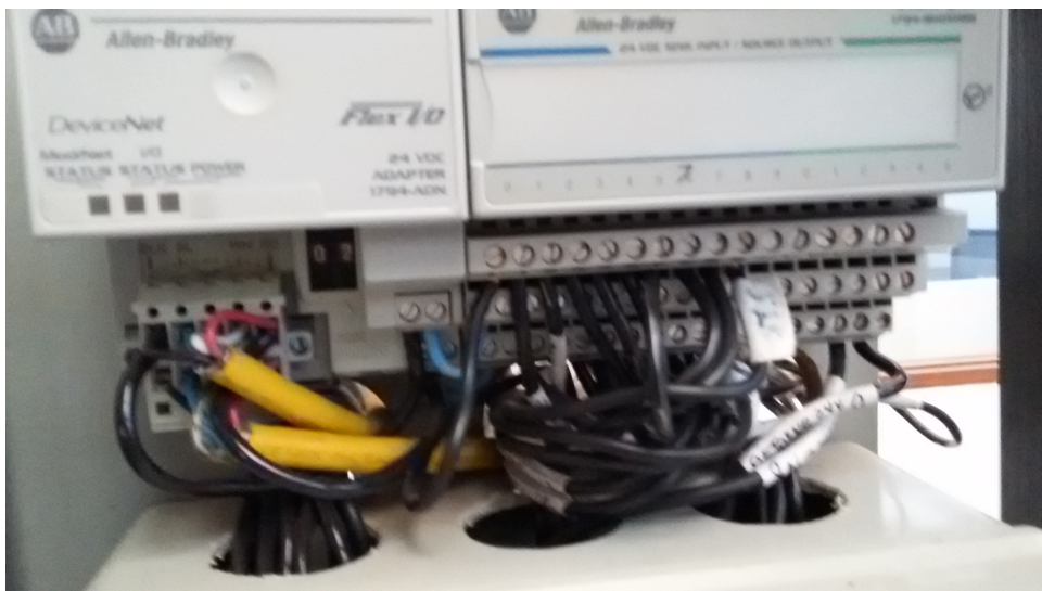
Figura 4.9: Conexões danificadas no Flex I/O.
