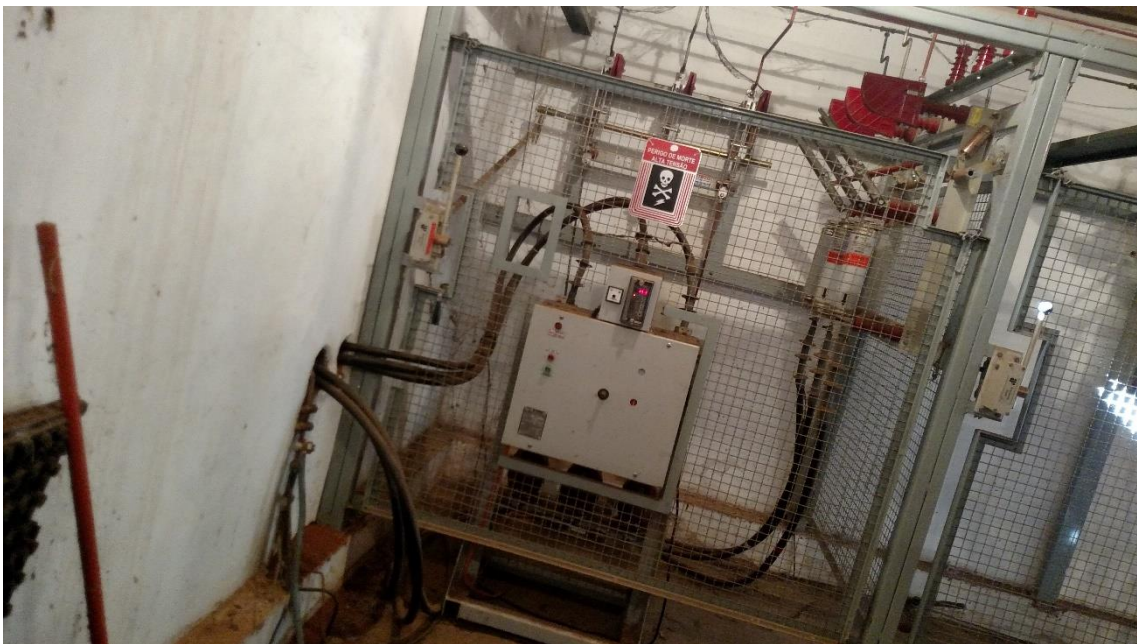
Figura AP1.6: Subestação do ICC Norte [6]
