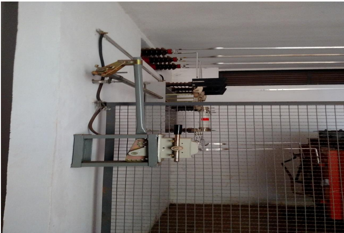
Figura AP2.4: Subestação da Reitoria [4]
