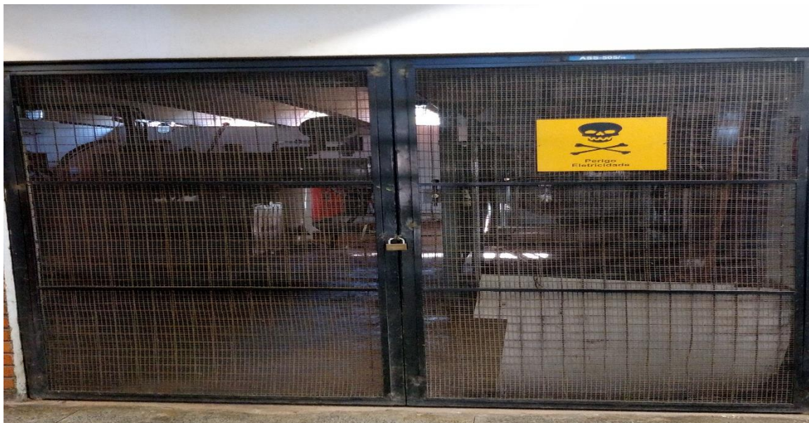
Figura AP1.1: Subestação do ICC Norte [1]
