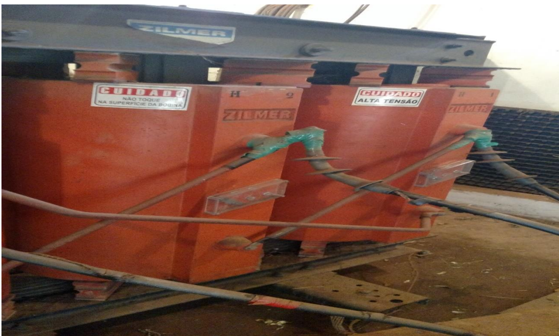
Figura AP1.4: Subestação do ICC Norte [4]
