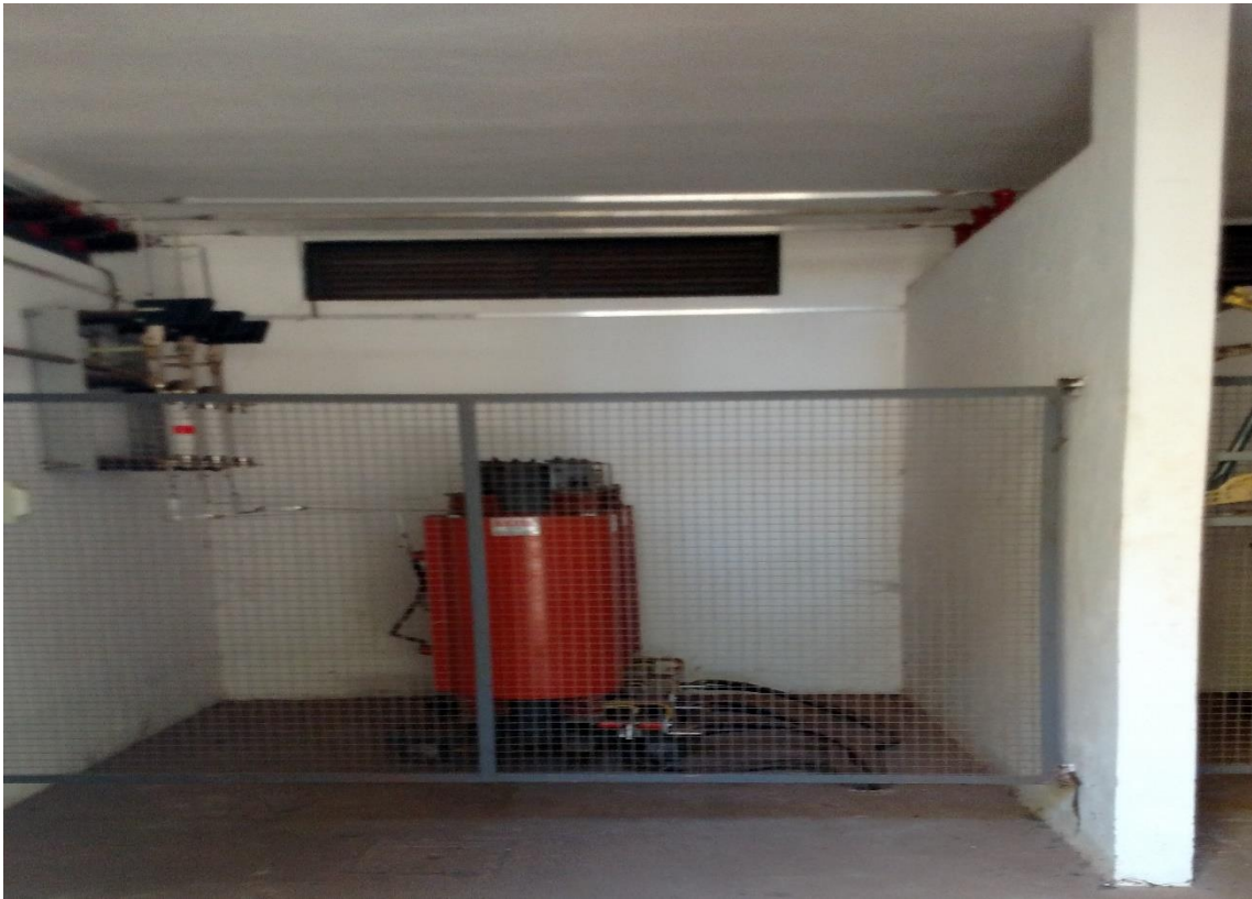
Figura AP2.3: Subestação da Reitoria [3]
