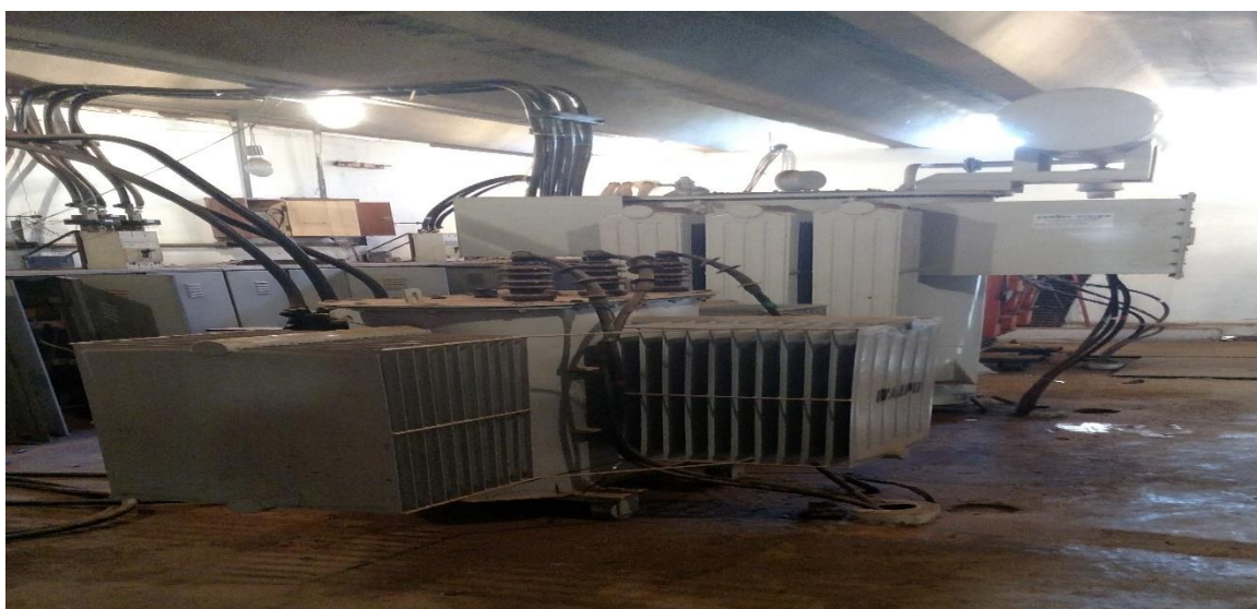
Figura AP1.2: Subestação do ICC Norte [2]
