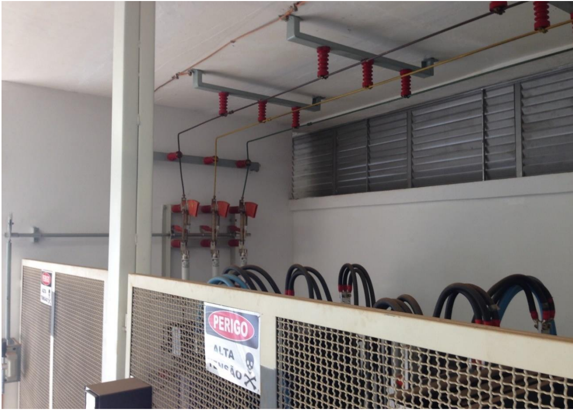
Figura AP3.3: Subestação da FACE [3]
