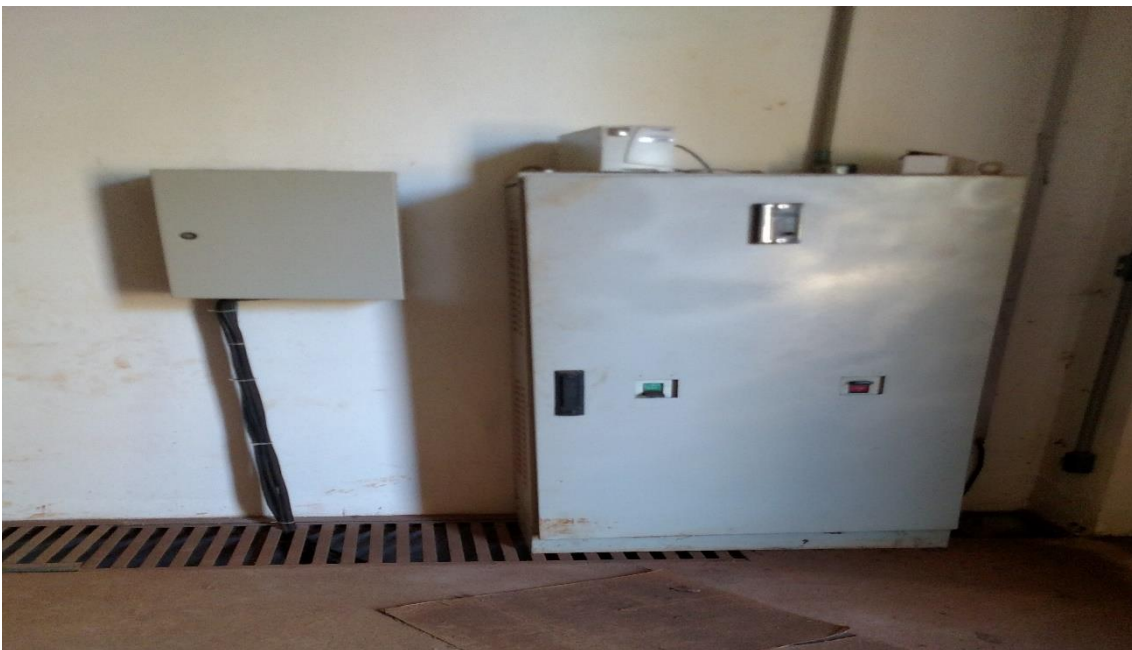
Figura AP2.2: Subestação da Reitoria [2]
