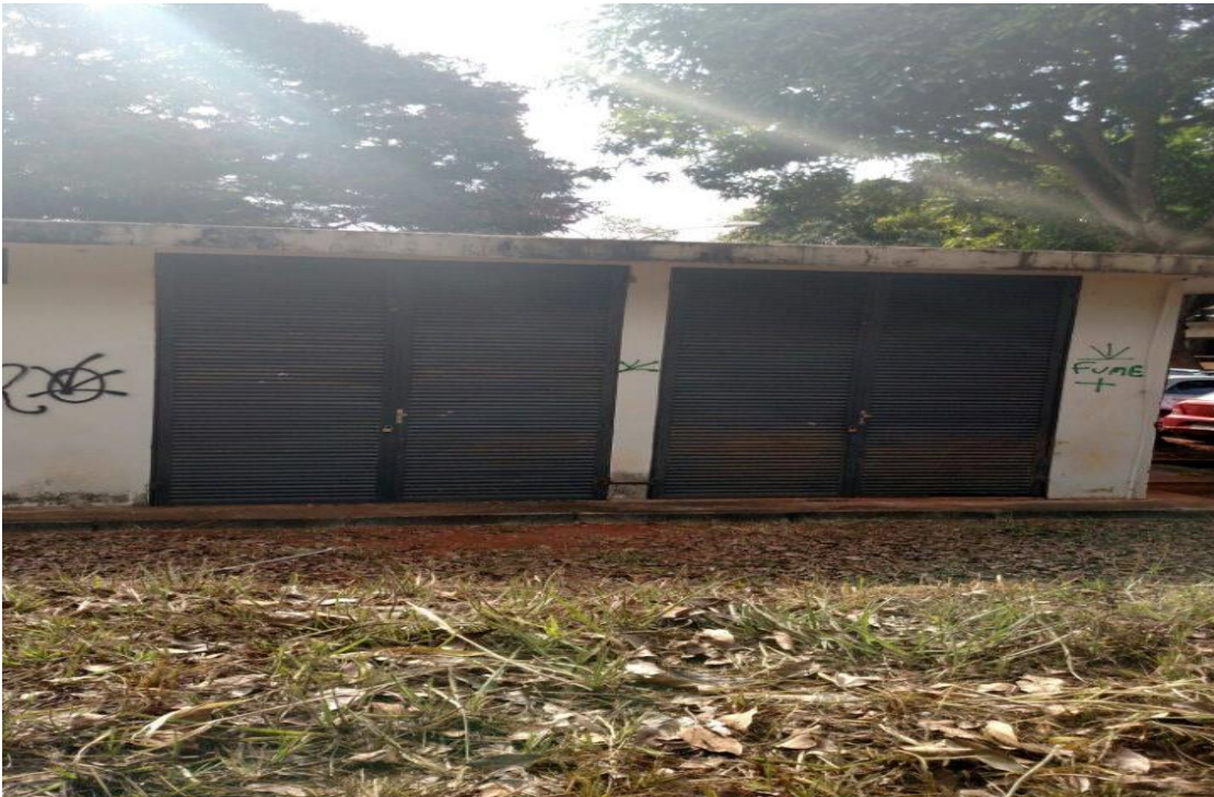
Figura AP2.1: Subestação da Reitoria [1]
