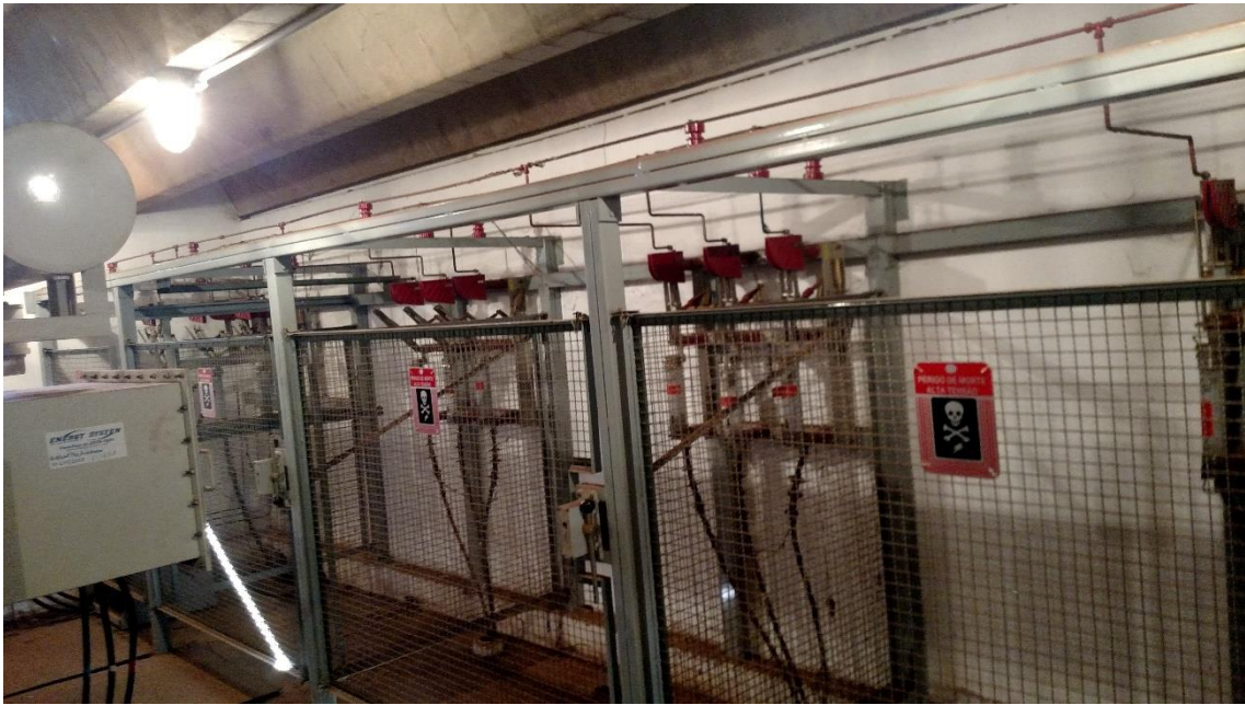
Figura AP1.5: Subestação do ICC Norte [5]
