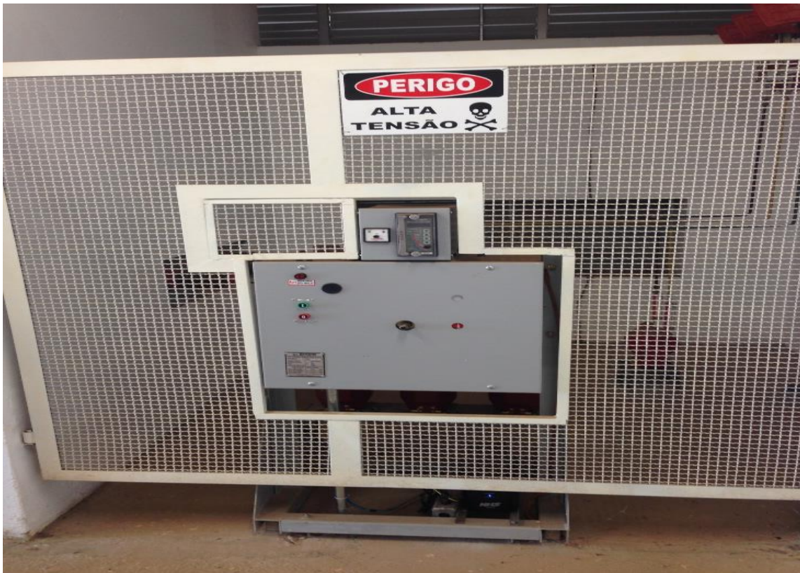
Figura AP3.4: Subestação da FACE [4]
