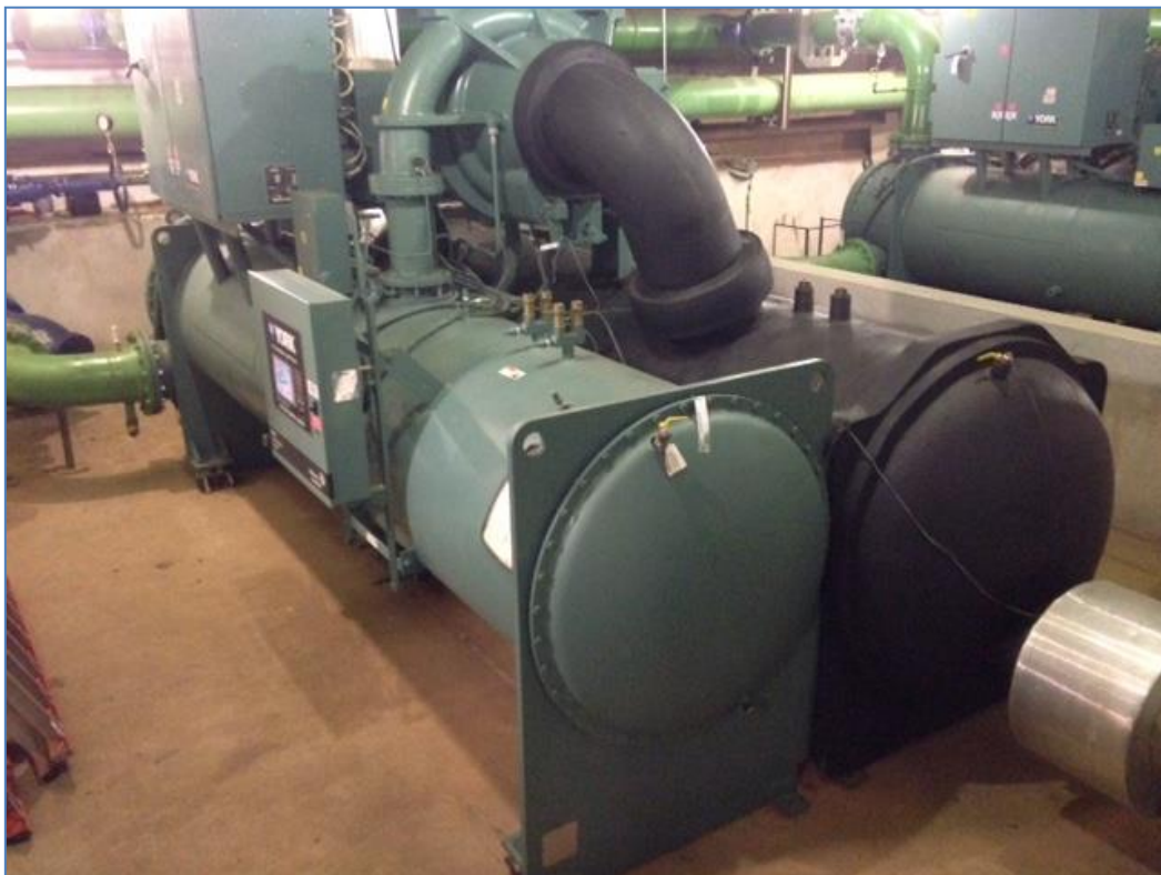
Figura 6.1 – Chiller centrífugo York.
