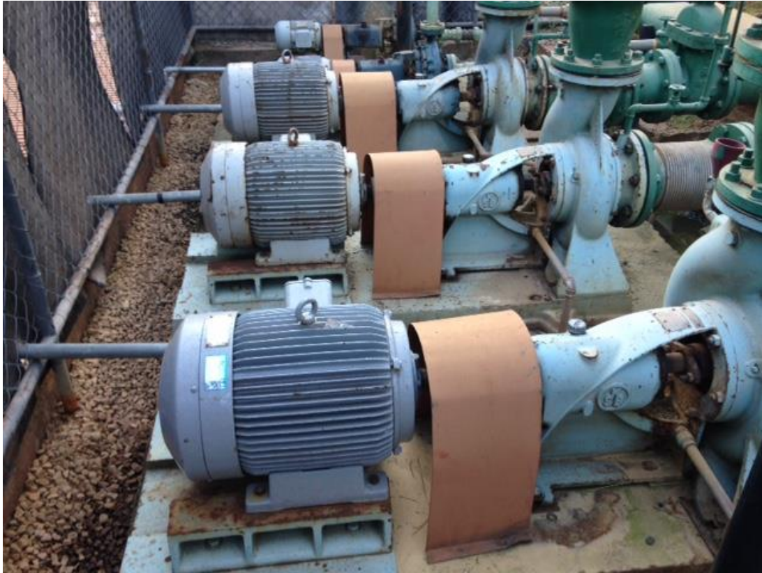
Figura 6.3 – Bomba de água condensada KSB.
