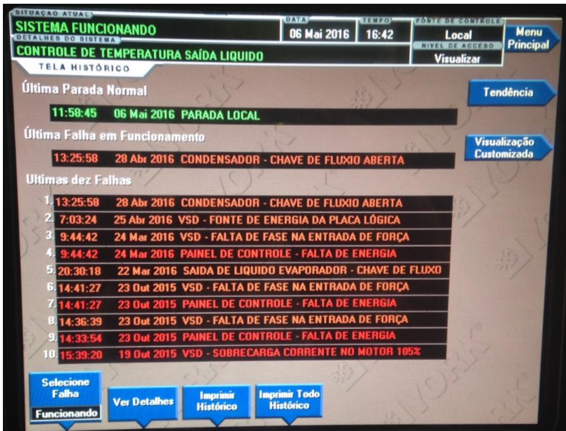
Figura 6.2 – Painel de controle do chiller com indicativos das ultimas falhas.
