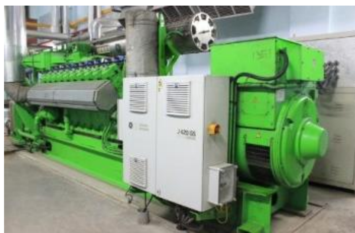
Figura 2.8: Instalação de trigerção na empresa Kanodia Technoplast. (Clarke Energy, 2015)
