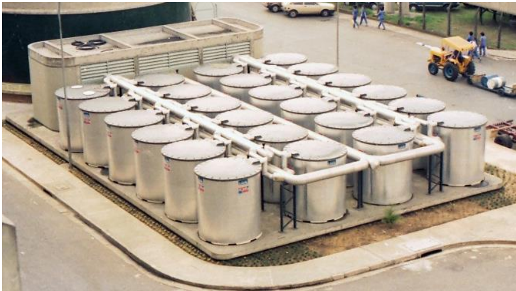
Figura 4.8: Tanques de termoacumulação da fábrica da Mercedes Benz. (Plareng, 2011)
