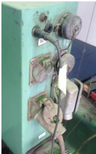
Figura 27. Vista posterior do quadro elétrico do painel de controle
