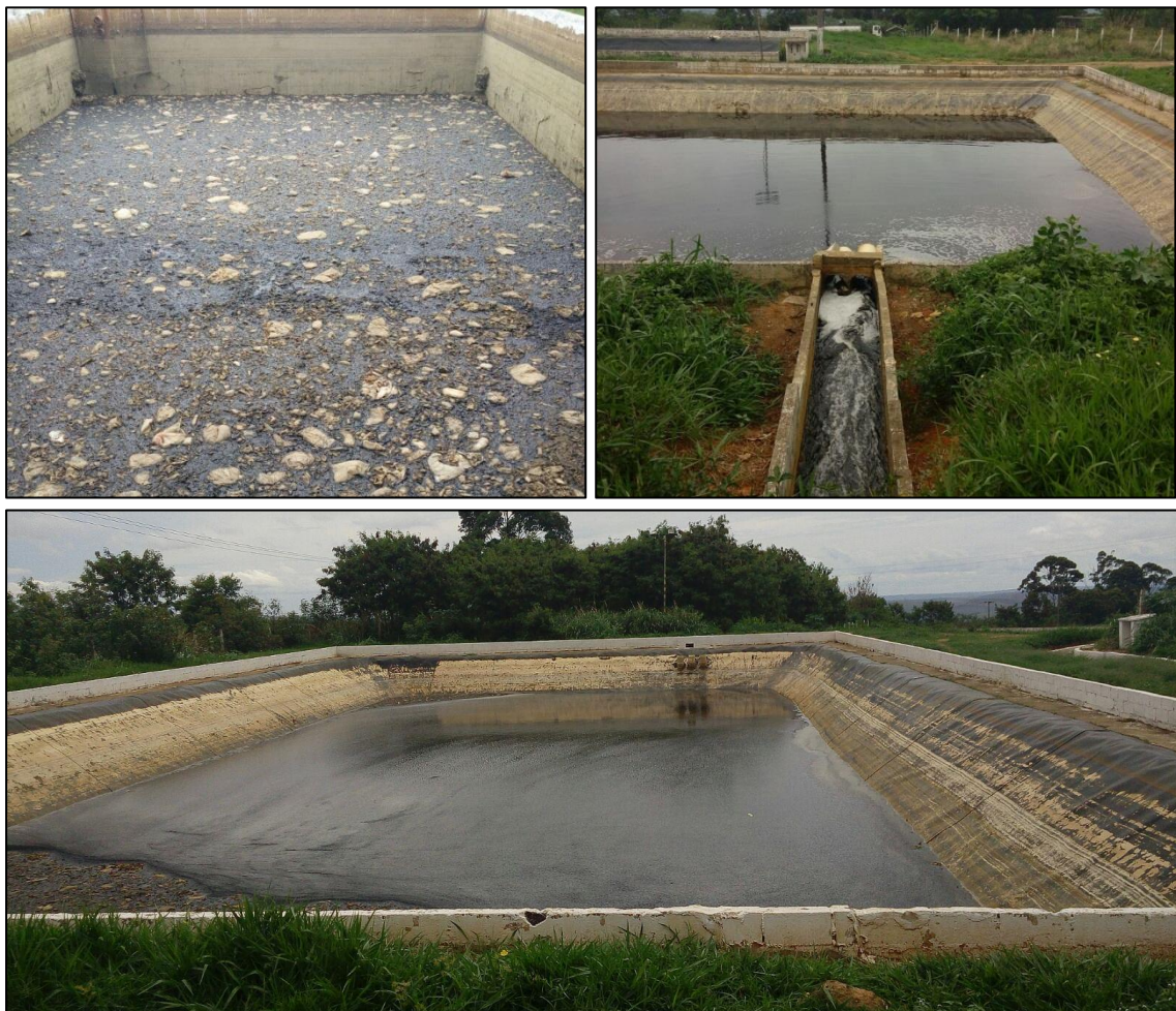
Figura 21 – Tanques de captação e tratamento de chorume.
