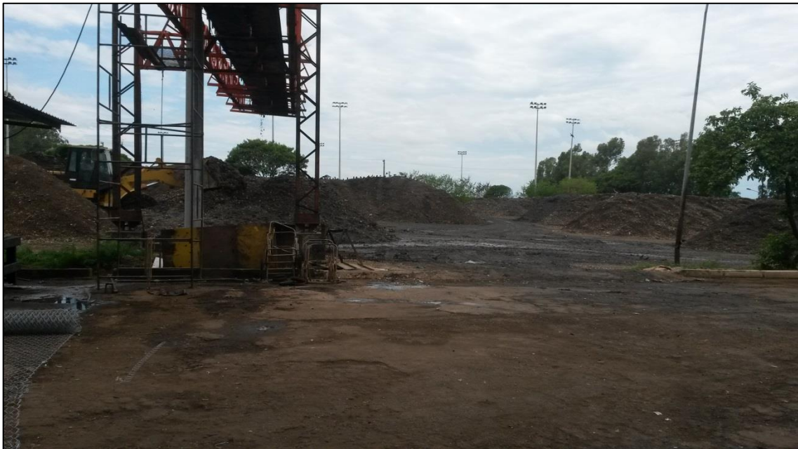
Figura 19 – Área das composteiras, mostrando esteira de deposição de material orgânico.
