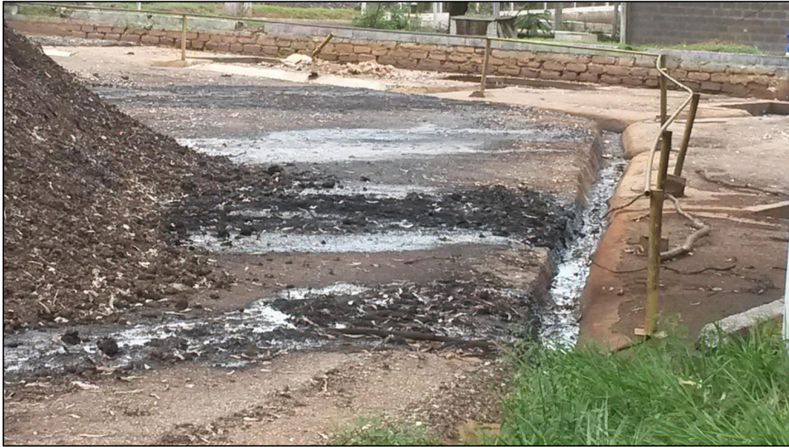
Figura 20 – Sistema de captação de chorume.
