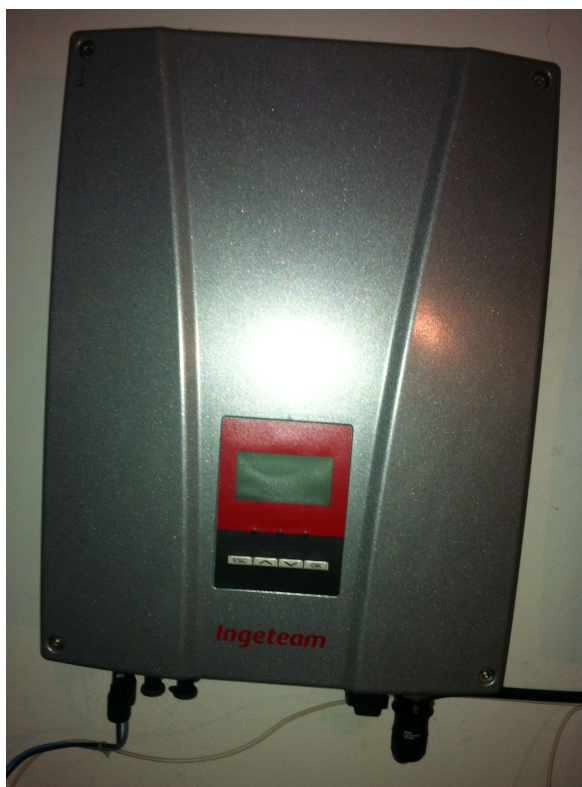
Figura 3.6 – Inversor da Ingeteam instalado na Embaixada da Itália
