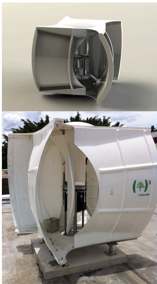
Figura 3.4 – Acima, uma imagem ilustrativa da microturbina, e abaixo, uma foto real da mesma já instalada no teto de Embaixada da Itália
