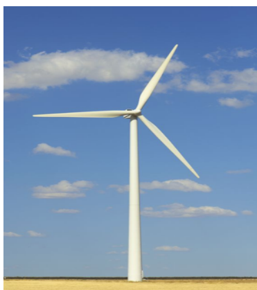
Figura 2.14 – Aerogerador eólico de três pás
