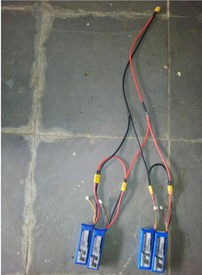
Figura 4.15: Detalhe da Conexão do Conjunto de Baterias.
