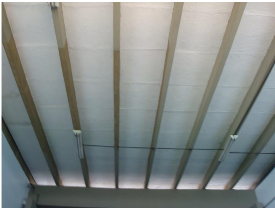
Figura 2.11. Teto do SG-09, foto tirada da entrada do prédio.
