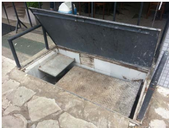
Figura 6.6 – Elevador de carga utilizado no restaurante Talher Brasil, CLN 306
