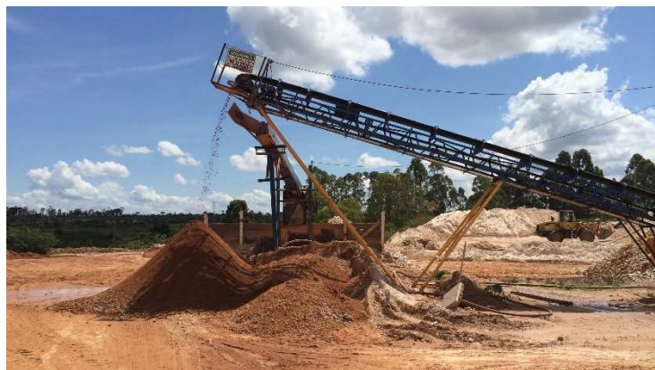
Figura 7.5 – Planta de reciclagem da Fornecedora de Areia Bela Vista.
