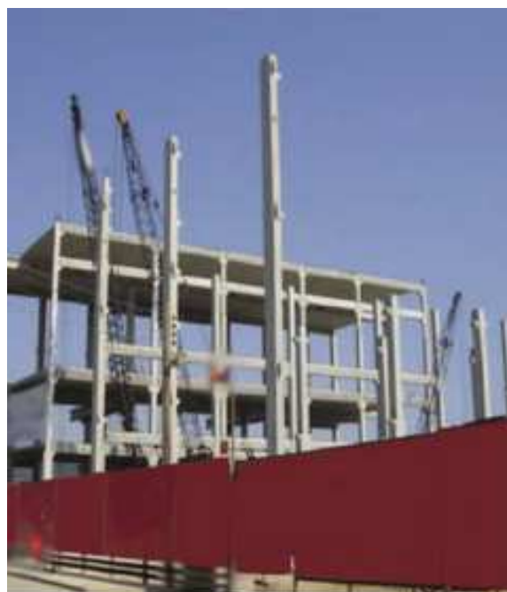
Figura 2.15 – Estrutura pré-moldada de concreto (Bourscheid, 2010).
