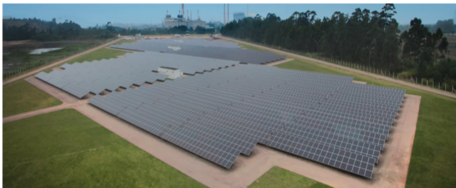
Figura 21. Central fotovoltaica de Tubarão (SC) (Tractebel Energia, 2014) [23]
