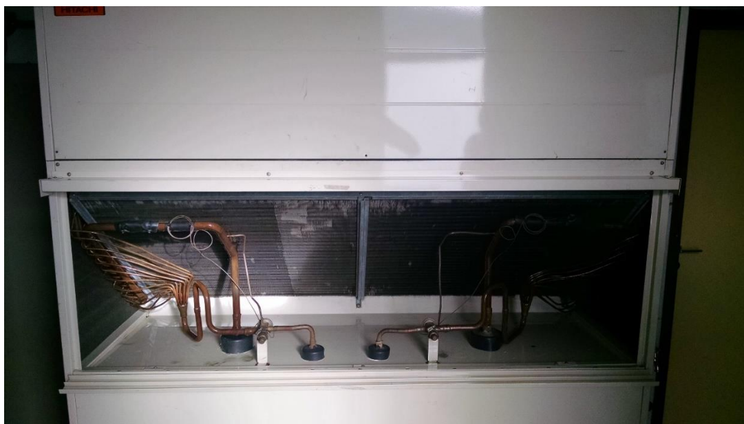
Figura 3.10 - Unidade evaporadora atual (O Autor, 2014)
