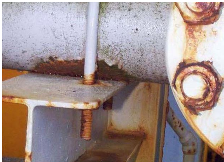
Figura 2-5 Corrosão em fresta entre o tubo e o parafuso e entre a porca e a chapa onde é parafusada ( Inspeção de equipamentos: Estudo de casos, 2014 )
