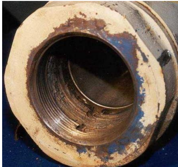
Figura 2-7 Corrosão galvânica em tubos ( BRANCO, 2011 )
