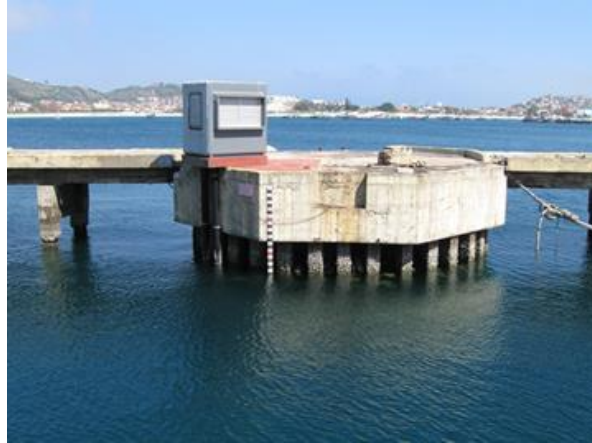
Figura 7 – Estação marégrafa no porto do Forno, Arraial do Cabo, RJ. Fonte: Portal IEAPM, 2015
