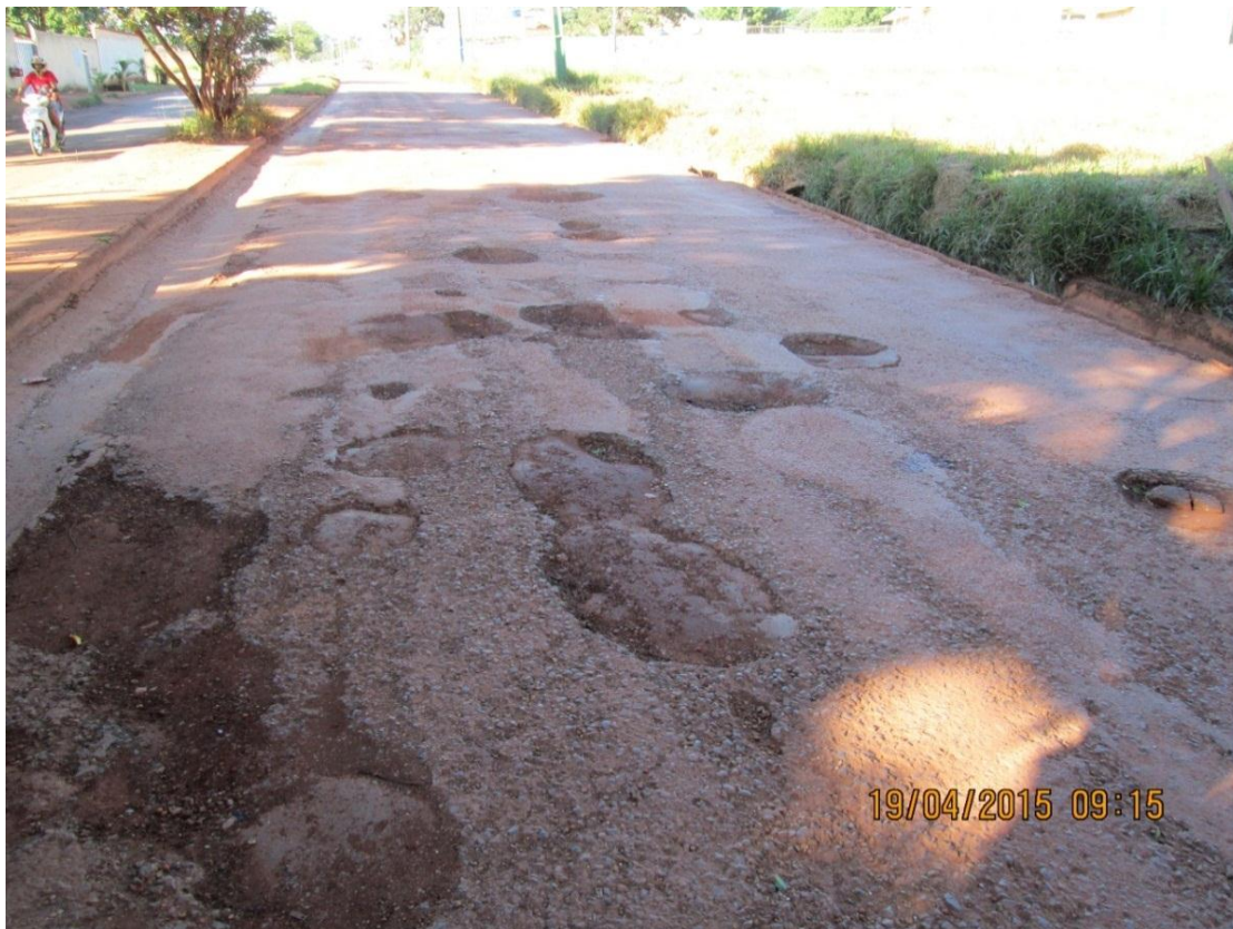
Figura 08: Estrada com resquícios do que sobrou do asfalto de baixa qualidade.
