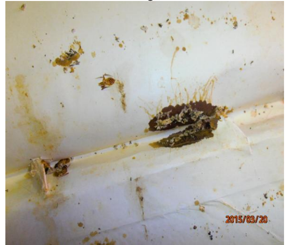
Figura 29 - Sujidades causadas por formigas
