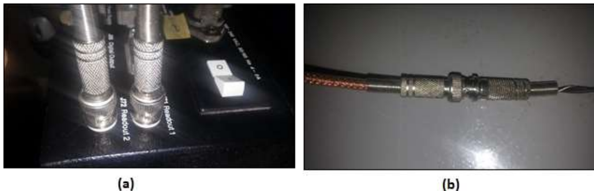
Figura 42 – a) Ligação do Cabo RGB no controlador da MTS, b) Junção de saída do cabo RGB.
