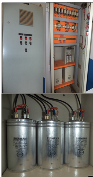
Figura 14 – Banco de capacitores da Estação Elevatória Beta.
