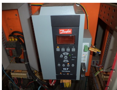
Figura 13 – Softstarters Danfoss da Estação Elevatória Beta.
