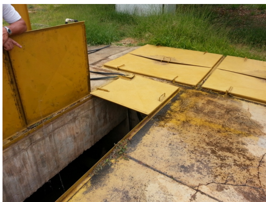
Figura 8 – Poço de sucção da Estação Elevatória Beta.
