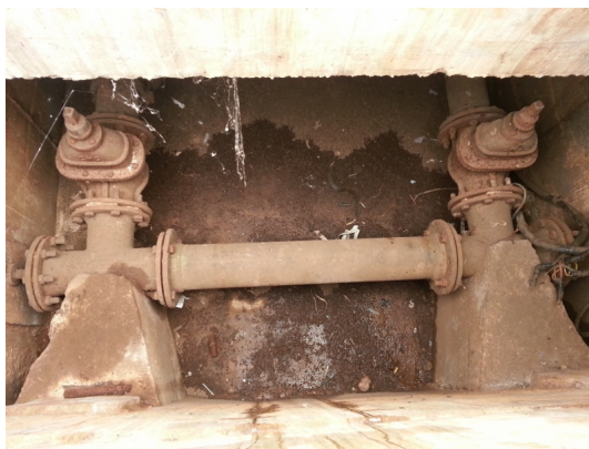
Figura 7 – Tubulação de recalque da Estação Elevatória Beta.
