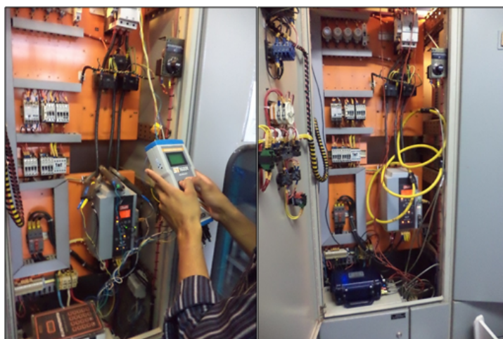
Figura 45 – Analisadores de energia instalados na Estação Elevatória Beta
