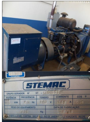
Figura 15 – Grupo motor gerador da Estação Elevatória Beta com destaque para a placa de características técnicas.
