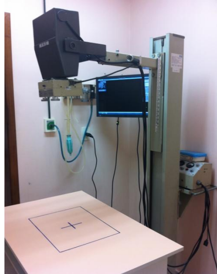
Figura 10. Sala de RX.
