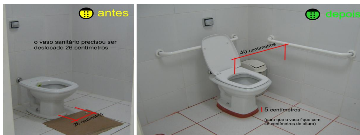
Figura 8 – Vaso sanitário, adaptado de http://thaisfrota.files.wordpress.com/2010/06/vaso-sanitario-antes-e-depois-depois-em-posicao-e-altura-adequada.jpg , 2013.
