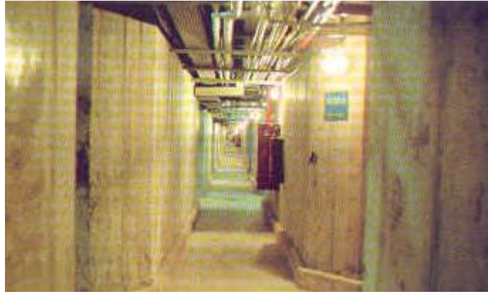
Figura 5.26 – Galeria de tubulações no subsolo (UFSC, 2012).
