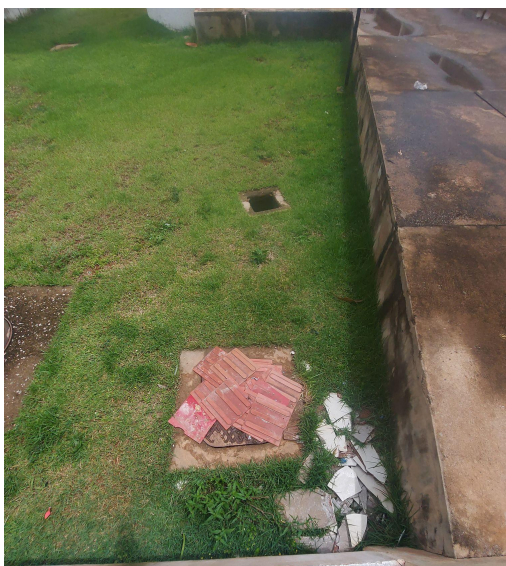
Figura n.º 13: piso tátil descolado no jardim do BSAN
