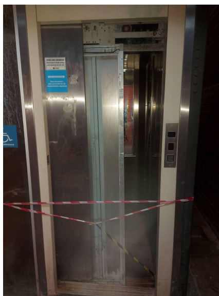
Figura n.º 9: elevador do ICC Norte
