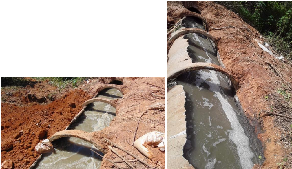
Figura 17 e 18. Imagem do rompimento das adutoras da ETE Melchior em 2021 (Alzirenio Carvalho)
