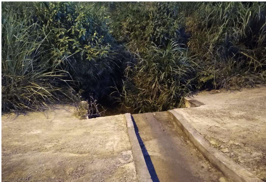
Figura 9. Condução de água da Estação Elevatória Vicente Pires da CAESB para corpo hídrico afluyente do ribeirão Currais. Imagem: Yuri Prestes
