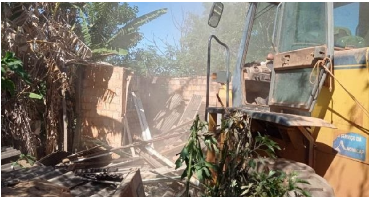
Foto 16 - Derrubadas na Vargem da Benção, Recanto das Emas.. Foto GDF Legal.
