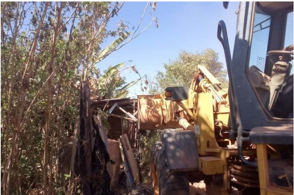
Foto 15 - Derrubadas na Vargem da Benção, Recanto das Emas.. Foto GDF Legal.
