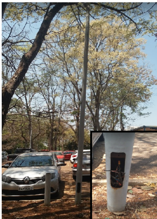
Figura 21: Poste metálico para iluminação sem a tampa da janela de inspeção
