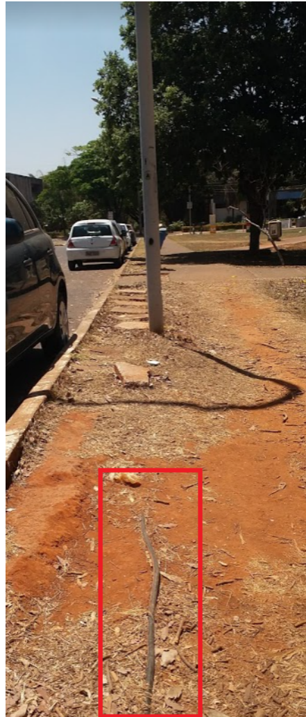
Figura 22: Poste metálico para iluminação com cabos elétricos de interligação expostos
