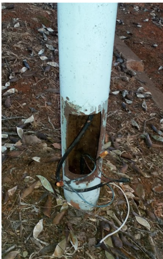
Figura 23: Poste metálico para iluminação com cabos em contato com o solo
