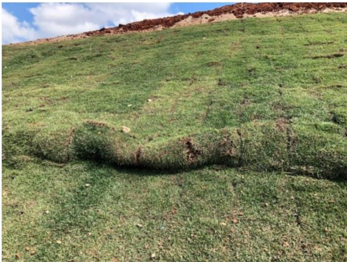
Figura 5.9 – Deslocamento horizontal da camada de cobertura (Carvalho & Pfeiffer, 2019).
