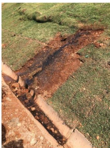
Figura 5.8 – Afloramento de lixiviado no talude do aterro ((Carvalho & Pfeiffer, 2019).
