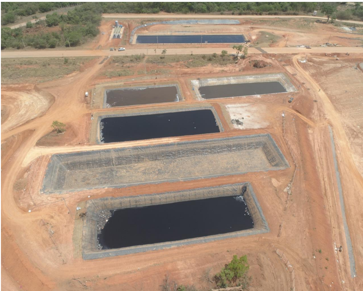
Figura 3. 17 - Lagoas de Lixiviado (cedida por SLU-DF, 2019).
