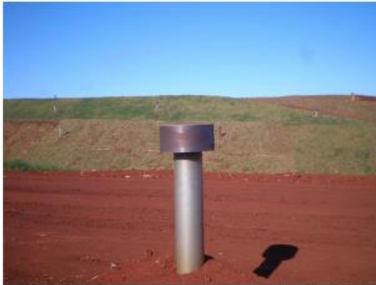
Figura 5.16 – Sistema de drenagem de gás (Doré Engenharia, 2016).
