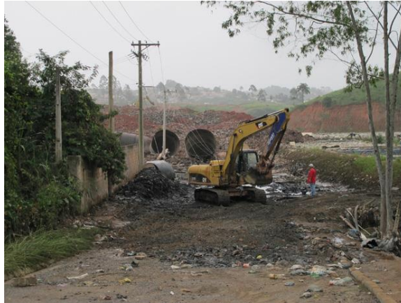
Figura 3.19 – Aterro Sanitário Pajoan após ruptura (Juliana Cardilli/G1, 2011)
