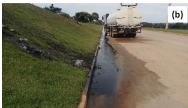
Figura 3.17 – Lixiviado extravasando pelo talude (Jucá et al. 2021)
