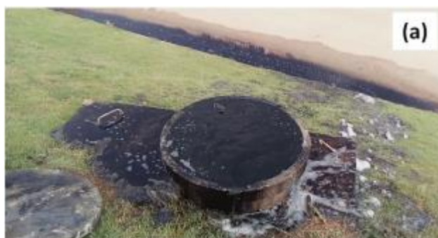
Figura 3.16 – Lixiviado extravasando pelo sistema de drenagem de gás (Jucá et al. 2021)
